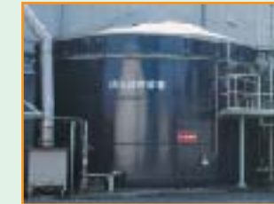
消化液貯留槽
