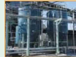
衛生化タンク
